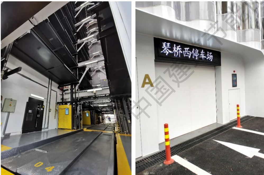
图 19-5 停车楼内设备及出入口
